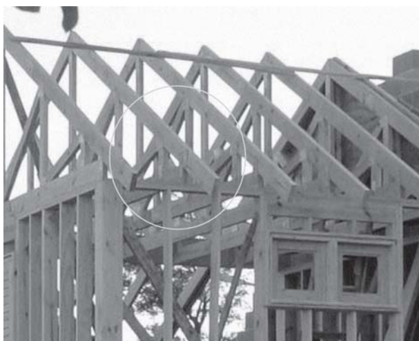
Figura 31: Falta de alinhamento com montantes da ossatura
