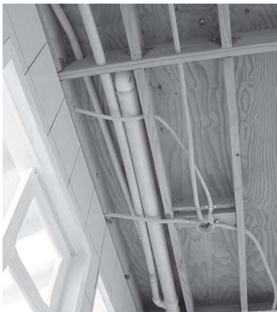
Figura 46: Tubulação de esgoto na laje de entrepiso
