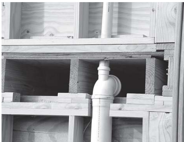
Figura 45: Ventilação do esgoto
