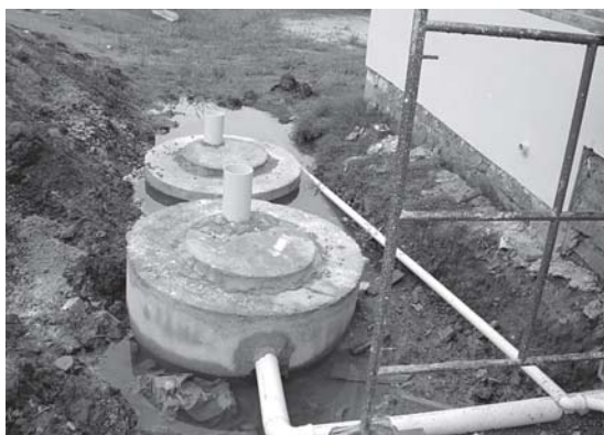
Figura 33 – Fossa séptica e filtro
